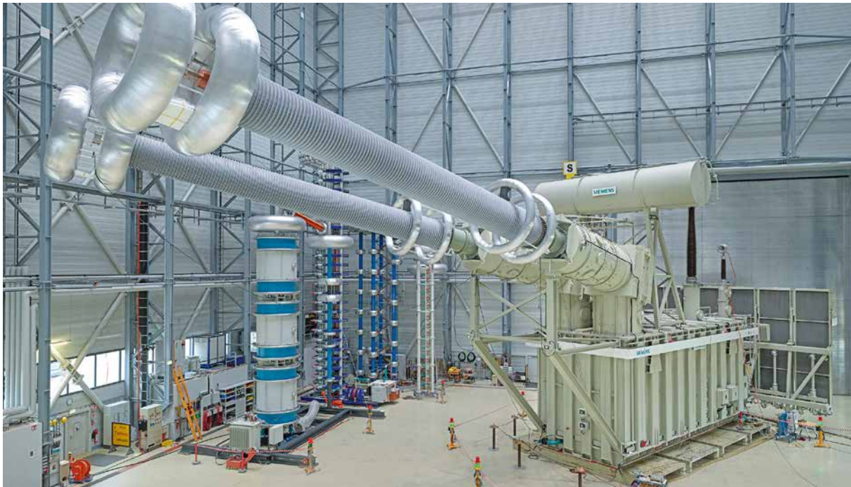
950 t Transformator der von 4 Luftkissentransportern im Prüffeld positioniert werden kann, Bilder © Siemens AG 950 t transformer, which can be positioned in the test bay by 4 air cushion transporters, Photos © Siemens AG
